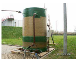
Reaktor SBR do oczyszczania wód poosadowych
