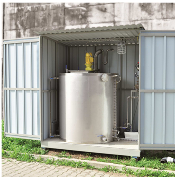
Fot. 3. Instalacja dozowania zewnętrznego źródła węgla organicznego do reaktora biologicznego (Mąkinia i wsp. 2013).
