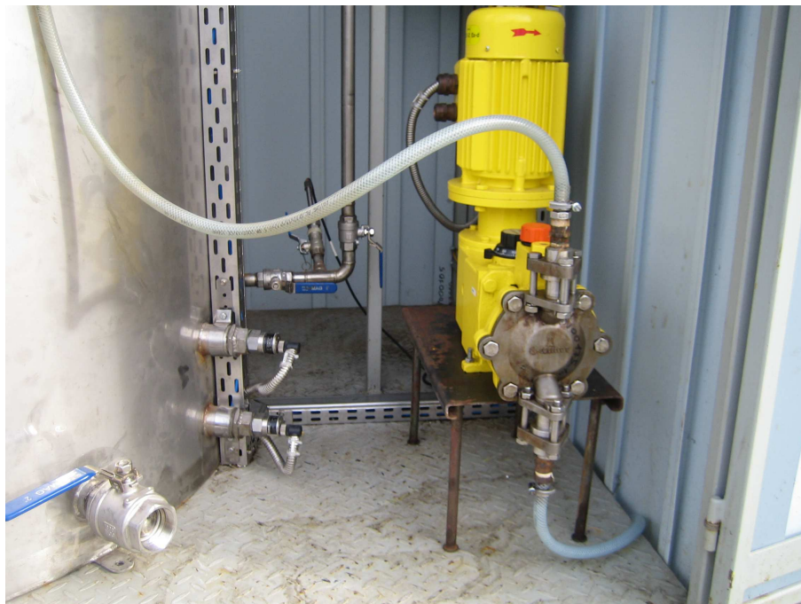
Fot. 9. Pompa do przetłaczania ZŻW ustawiona wewnątrz kontenera
