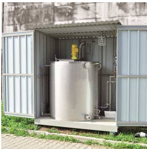
Fot. 2. Kontener stacji dozowania zewnętrznego źródła węgla organicznego wraz ze zbiornikiem i armaturą
