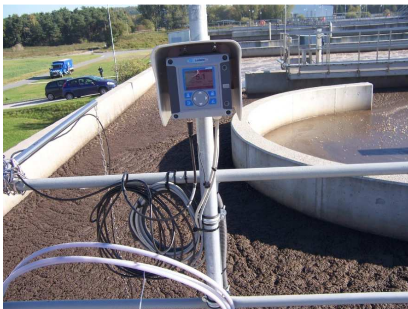
Fot. 8. Przetwornik sondy NITRATAX plus sc zainstalowany do bariery bioreaktora w trakcie badań w skali pełnotechnicznej w GOŚ „Dębogórze” w Gdyni
