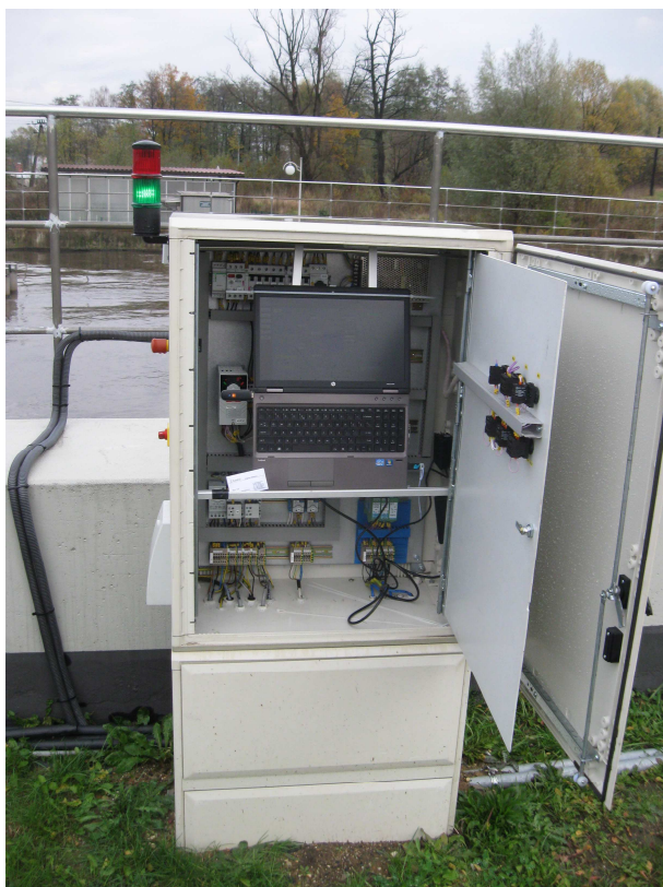
Fot. 7. Widok wnętrza szafki sterowania wraz z komputerem przenośnym
