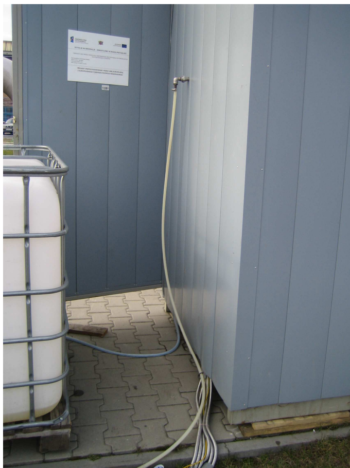
Fot. 4. Elastyczny przewód tłoczy podłączony do instalacji dozowania ZŻW w kontenerze
