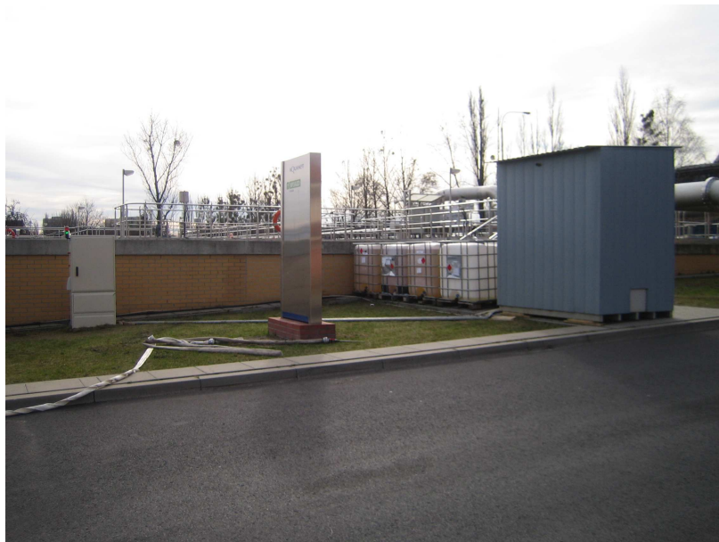
Fot. 5. Kontener i szafka sterowania stacji dozowania na terenie LOŚ w Poznaniu
